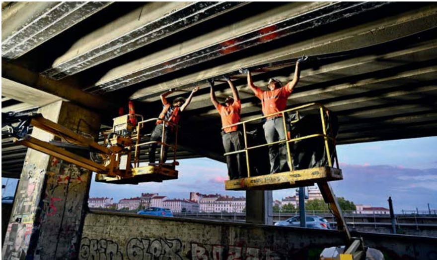
Pose d'une lamelle de carbone sous une poutre du pont de la Brasserie.
